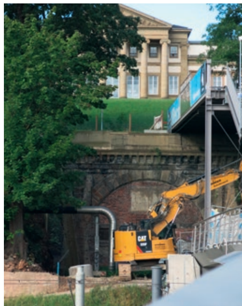
Abb. 2: Ehemaliger Bahntunnel unter Schloss Rosenstein, Zustand Sommer 2023 [3].
