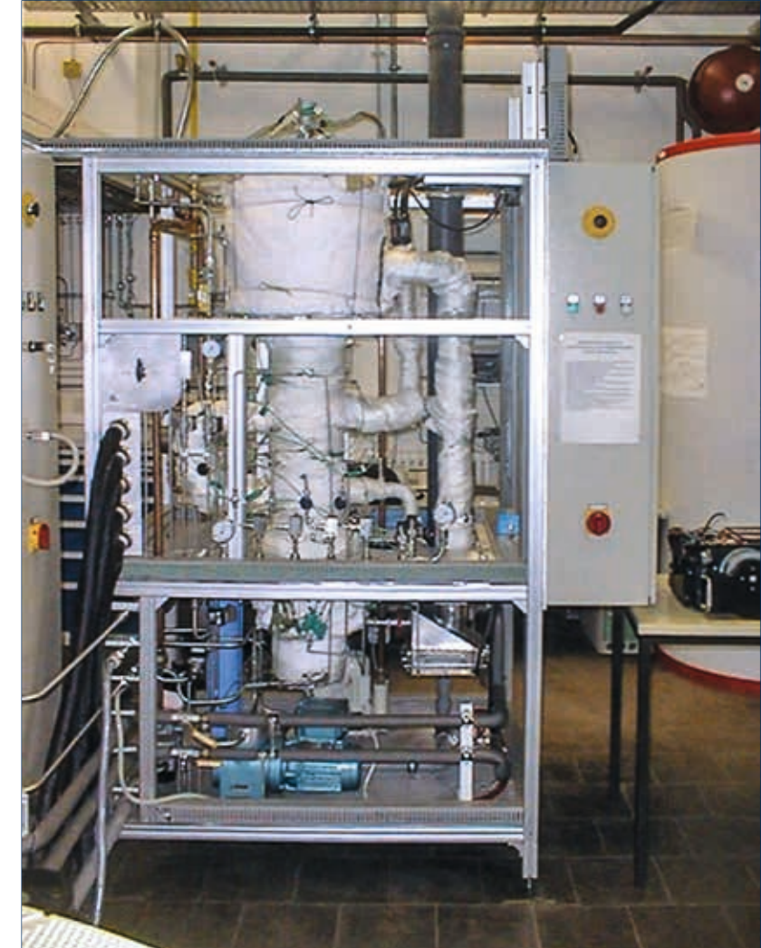
Reformer-Teststand zur Einbindung von Brennstoffzellen im konventionellen Erdgasnetz
