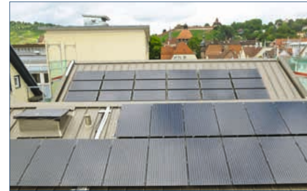
PVT-Module, kombinierte Photovoltaik- und Thermienutzung, auf dem Dach des Neubaus
