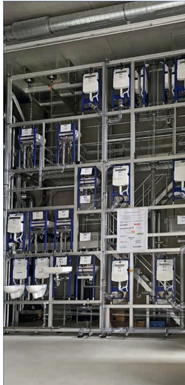
Abwasserturm zur Demonstration des fachgerechten Einbaus von Sanitär- und Entwässerungseinrichtungen
